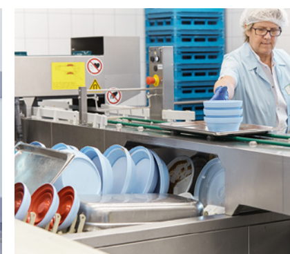
Spülküche Schmutzbereich. Spülmaschinenbeständigkeit aller Systemteile.
